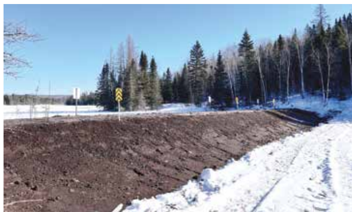
Digue filtrante terminée recouverte de terre végétale pour l'ensemencement de plantes herbacées indigènes.
