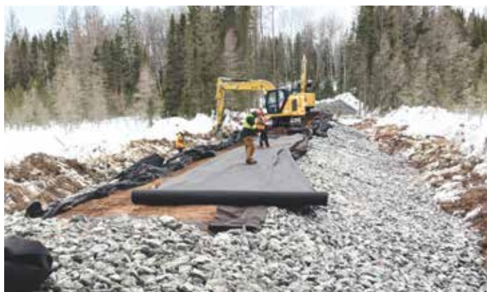
Digue filtrante en construction avec un cœur en tourbe et une carapace de toile géotextile filtrante recouverte de pierres.
